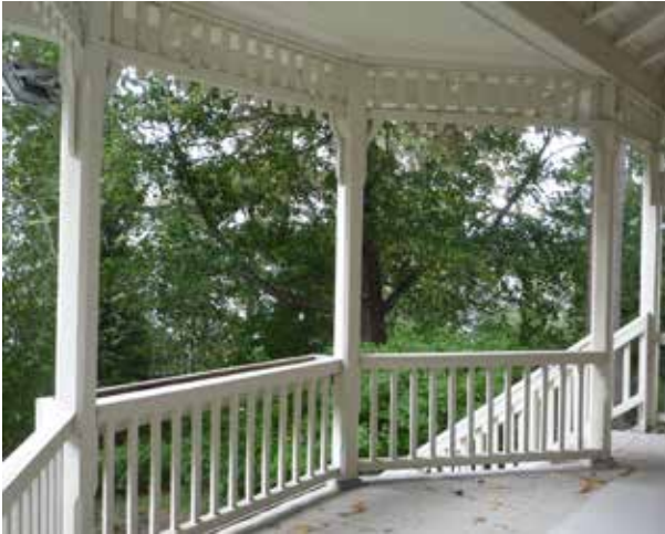
Näkymä verannalta Pyhäjärvelle. Kaiteen puurakenteet on uusittu, yläosan koristeaihe on todennäköisesti alkuperäinen.
